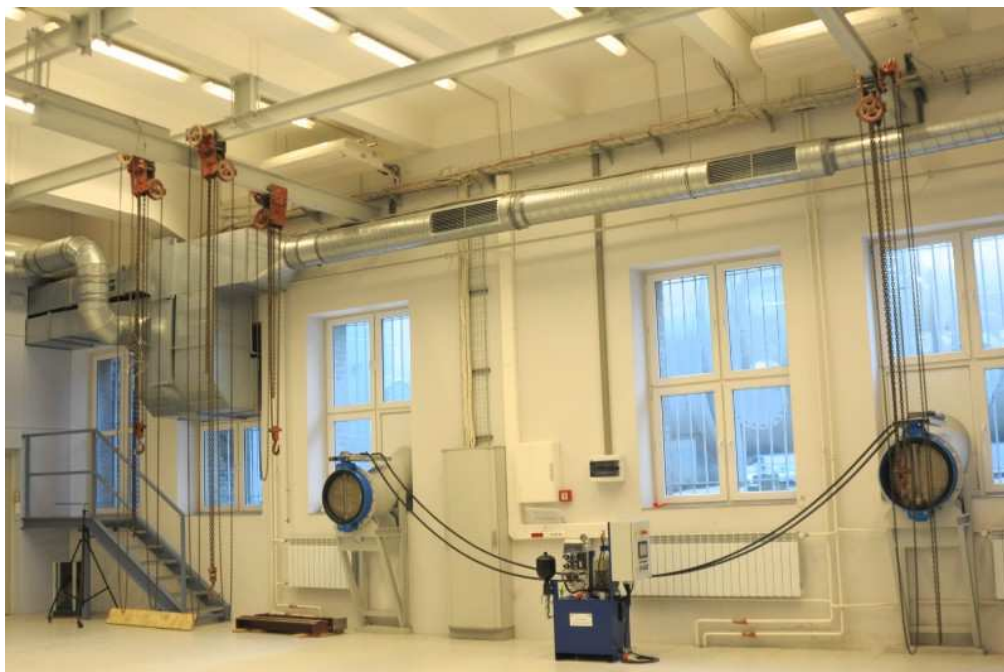
Rys. 12 b Widok laboratorium z zasilaczem hydraulicznym (w środku) oraz dwoma przyłączami do tuneli: lewe tunel transoniczny; prawe tunel łopatkowy
